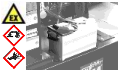
Batería de alimentación: peligro de corrosión, explosión.
